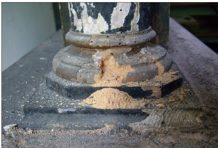
5. Zły stan zachowania drewna – zniszczone fragmenty (fot. B. Wiczorek)
